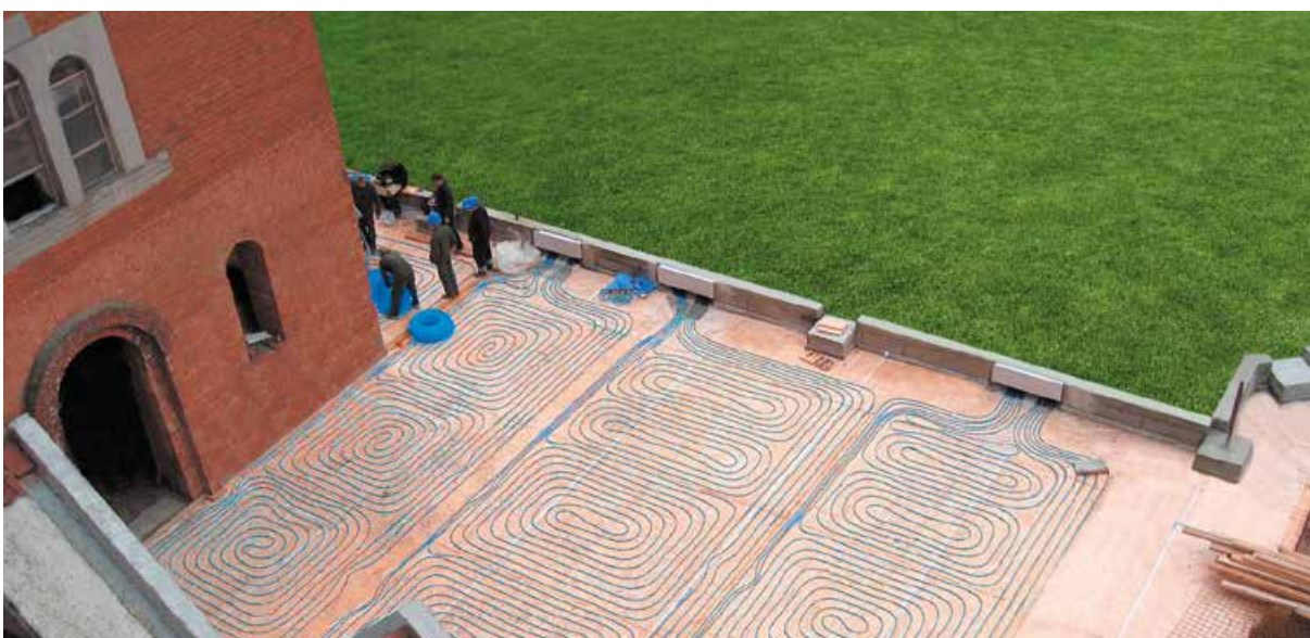
Фиг. 5. Отоплителна инсталация на външна тераса с използване на тръби KAN-therm система bluePERT.
