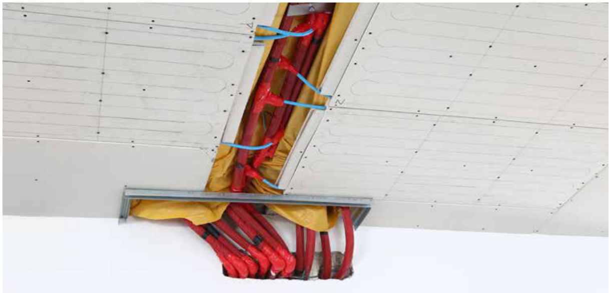
Фиг. 6. Таванна охладителна инсталация с отоплителни и охлаждащи панели на системата KAN-therm Wall.
